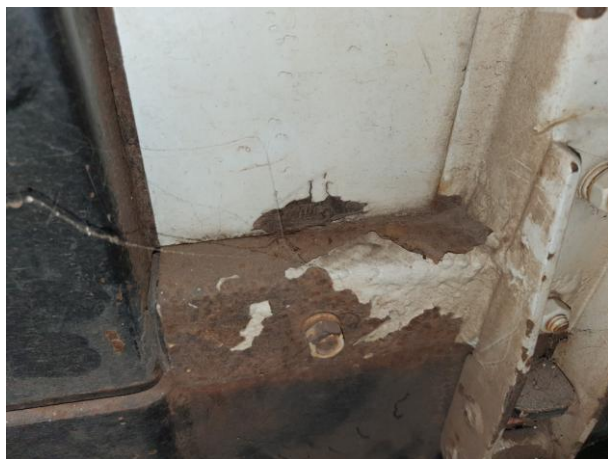
Foto 5: corrosão das longarinas
